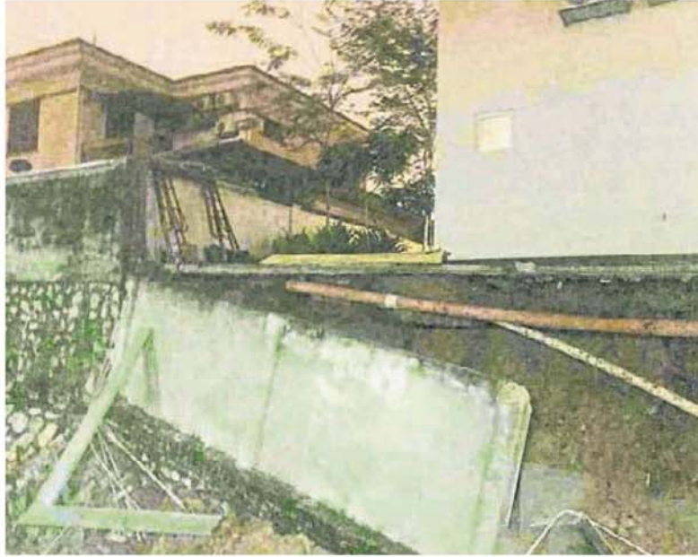
■獨立式洋房后面的圍牆突然坍塌。
