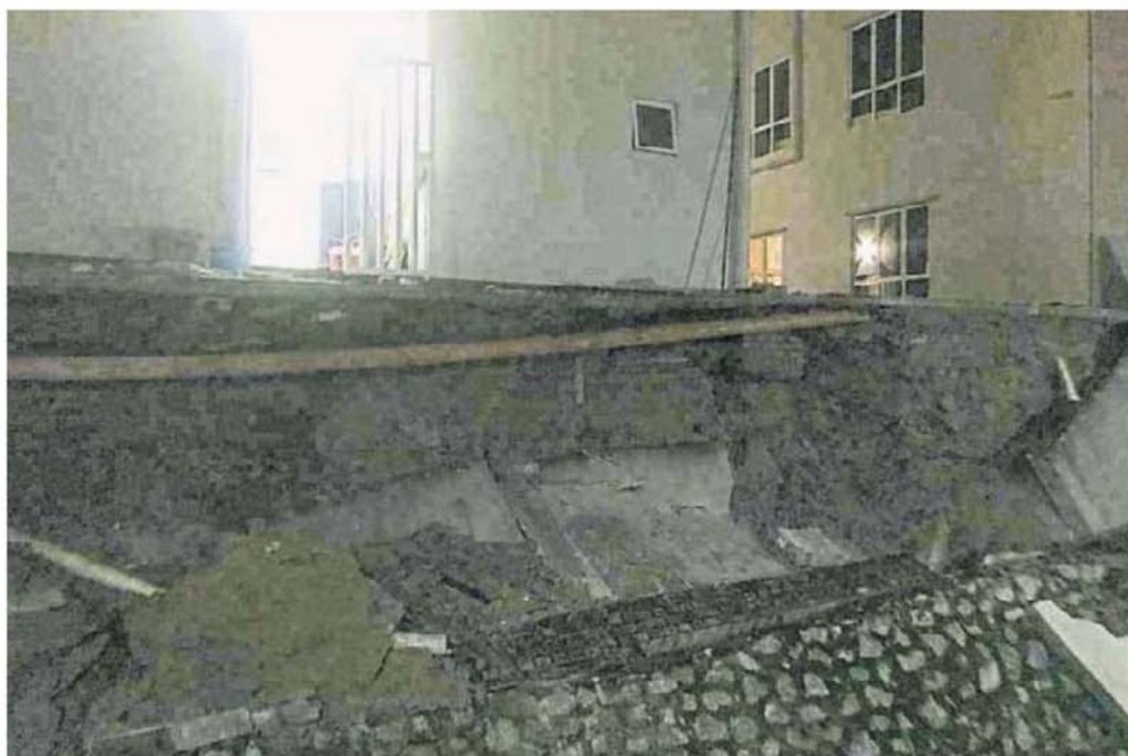
■所幸坍塌部分没有涉及其他屋子。
