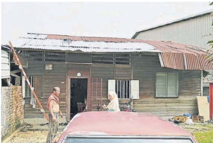
■仙水港受灾影响的住家，屋主已自行维修屋顶锌板。
